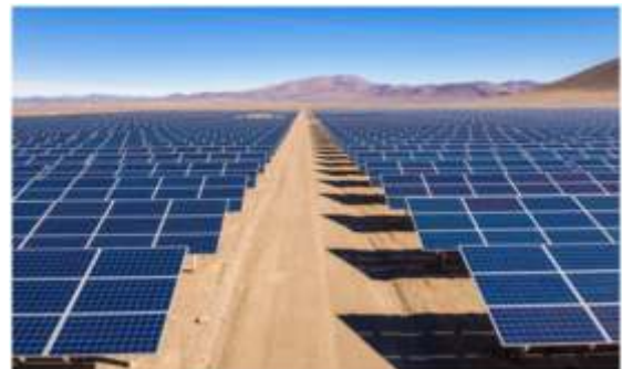
PLI: Solar PV Modules
